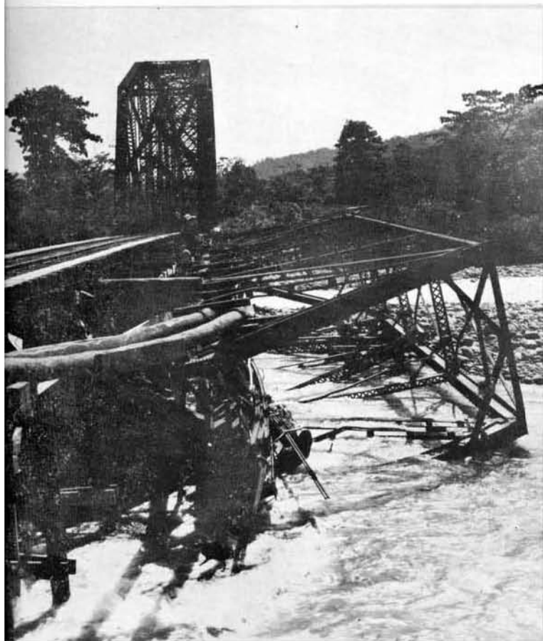
En Diciembre 1943 al hacerse más hondo el cauce socavó los cimientos del tramo en la ribera oeste del río, haciendo que el puente y los cimientos se volcaran río arriba. La fotografía muestra la armadura en el río después de ser completado el puente provisional de pilotes. La armadura original fué luego desmontada, reparada y reconstruída. La estacada que se ve sobre viaducto provisional y tramo caído se había usado como puente para pasar pasajeros y carga pequeña durante los días antes de ser completado el viaducto provisional y resumido el tráfico regular.
