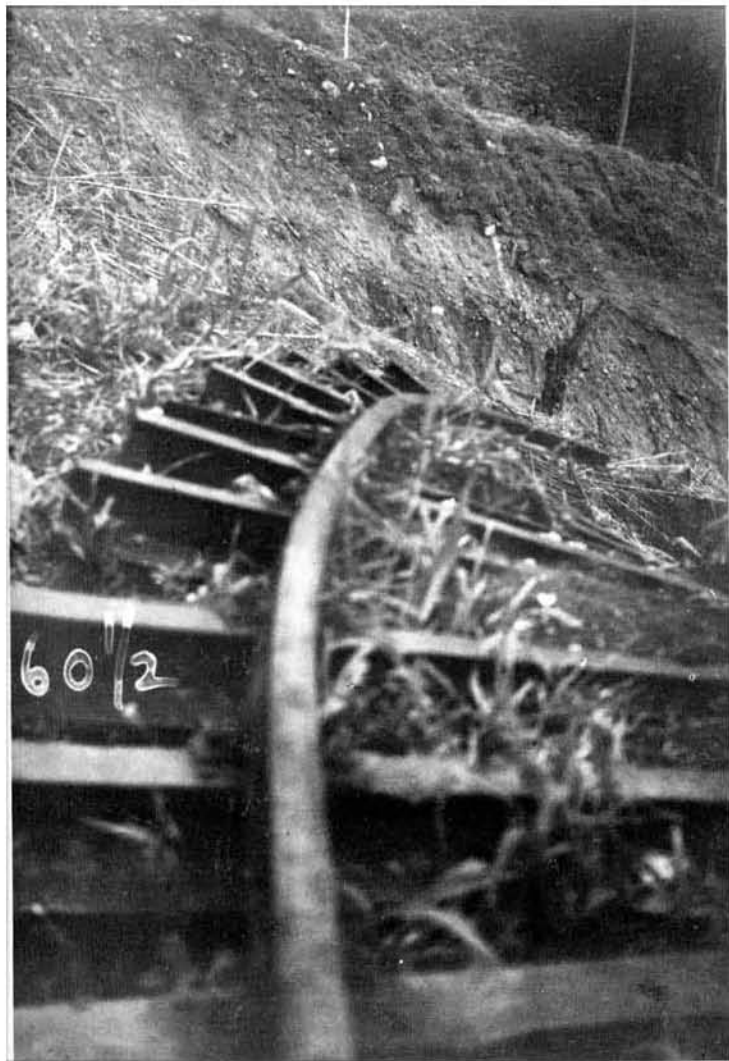
Un derrumbe demolió el terraplén, así como la vía, empujándolos hacia el fondo de la montaña.
