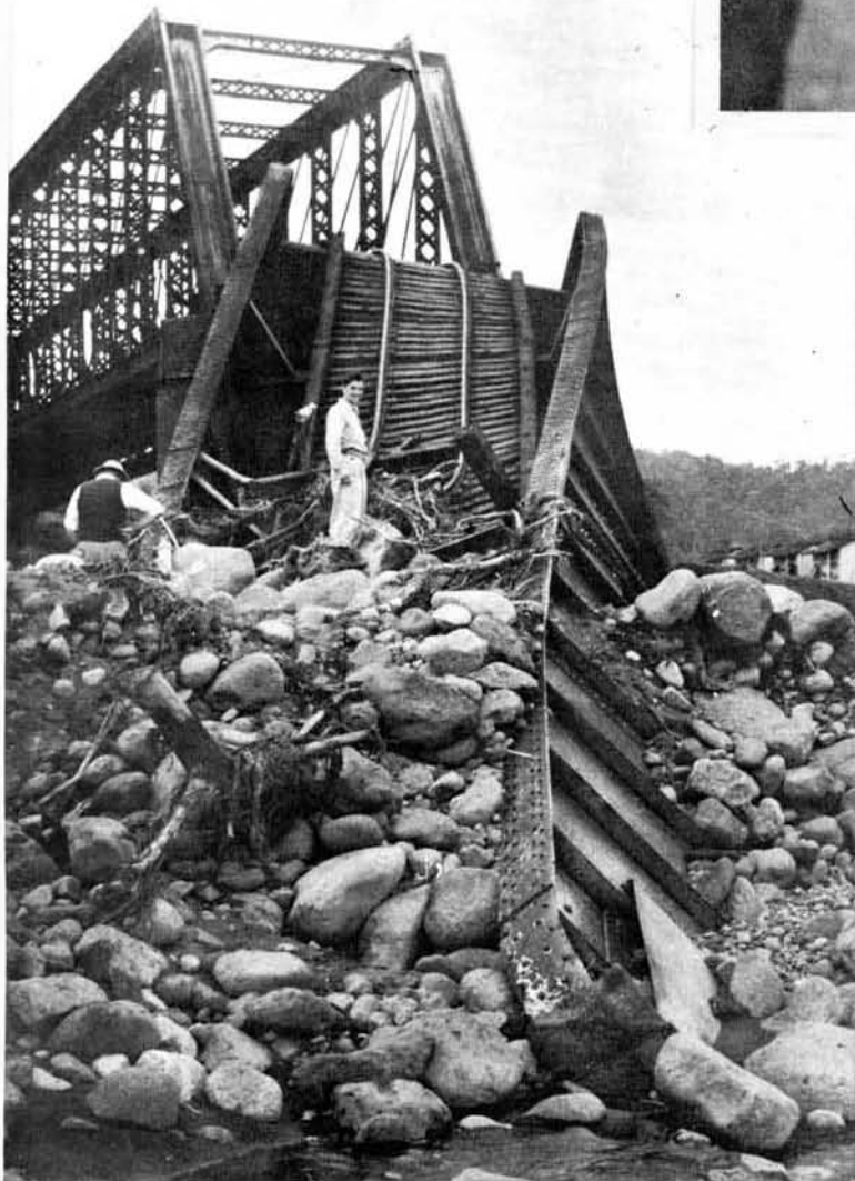
El puente de vigas de 80 pies cayó aguas arriba después que los cimientos fueron lavados. Nótese el tamaño de las rocas llevadas por el río.
