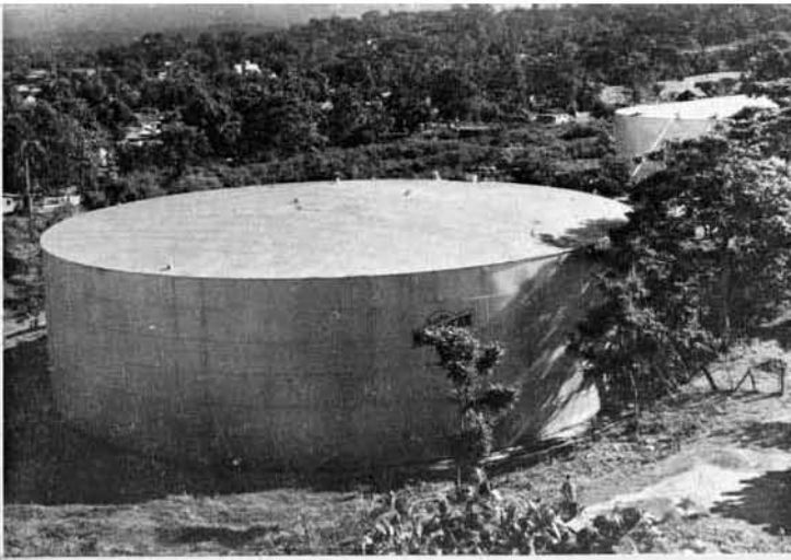
Estos tanques, con una capacidad de 55,000 barriles cada uno, contienen la reserva principal de combustible. Durante el año fiscal 1952-1953 pasaron por estos tanques 181,286.08 barriles de combustible, con un valor total de $ 382,844.02 (C 2,170,725.59).
