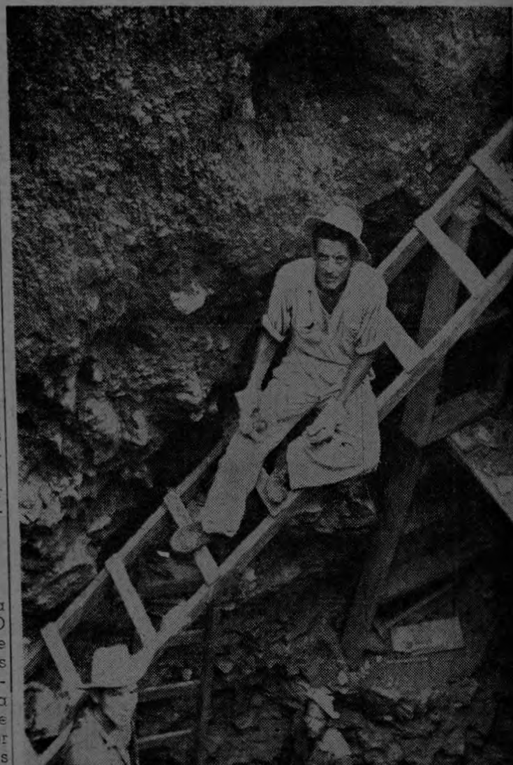
Sin duda alguna, el trabajo que han venido realizando los barreteros al servicio de la empresa constructora del puente sobre el río Térraba es de las más difíciles. En el sitio donde se está construyendo el último de los bastiones de ese puente, en la orilla Sur del río, ha sido preciso barrener la roca y vemos aquí a tres expertos trabajadores: Reinaldo Ramos, Pedro Chavarria y Edmundo Méndez, cuando hacen un pequeño alto en sus tareas, en tanto nuestro fotógrafo hacia esta gráfica de los hombres en el profundo hueco donde se levantará el bastión.
