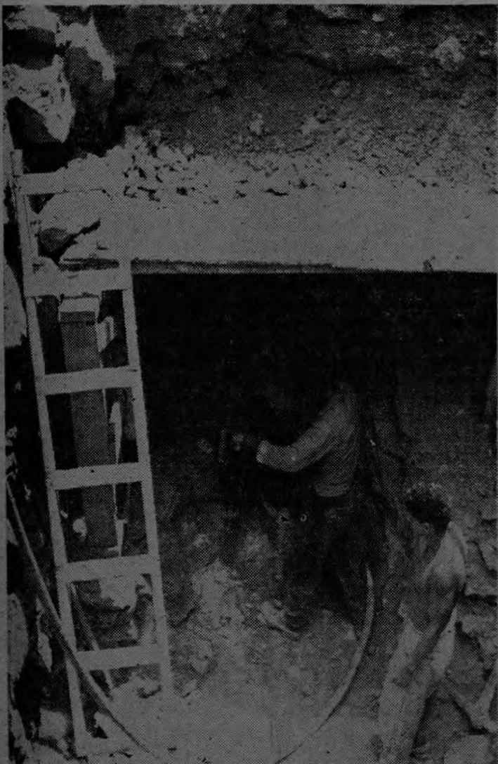
Ismael Campos sostiene el taladro eléctrico con que perfora la dura roca de la ribera Sur del Rio Grande de Térraba. Al lado suyo, Alejandro Obando, otro experto barretero de los que trabajan en las obras de ese gran puente. La foto recoge el momento cuando los trabajos habían alcanzado 23 pies de profundidad.
