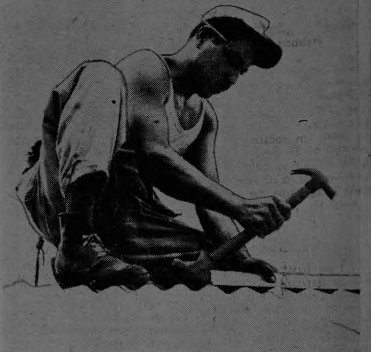
Don Carlos Alberto Martínez, es el nombre de este carpintero del Departamento de Construcción de Coto. El señor Martínez trabaja arduamente, junto con muchos otros compañeros, para construir las casas de nuevo tipo que se levantan en las nuevas Fincas de Coto.
