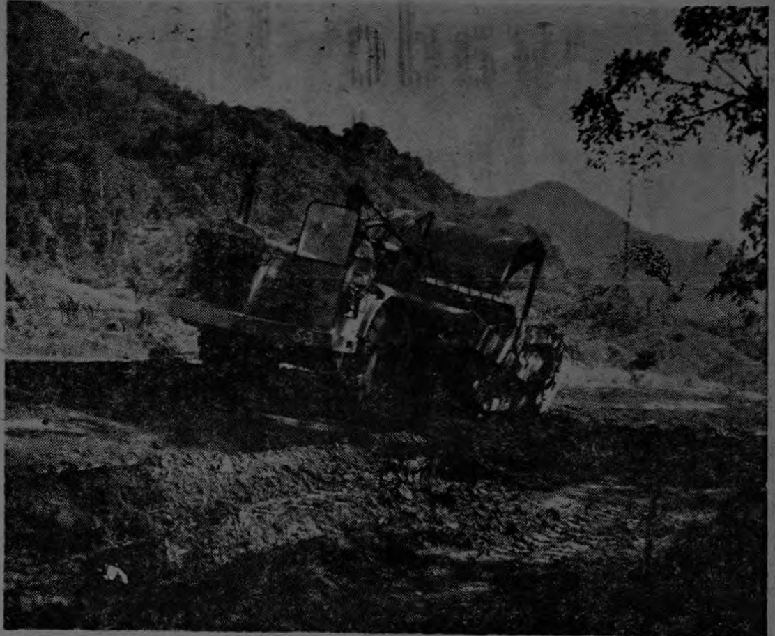
Un enorme tractor D. W. 21, trabaja afanosamente en la trocha de la Carretera Interamericana, sección Sur, en Palmar Norte. Esta tremenda maquinaria, la de mayor envergadura que trabaja en el país, es una de tantas unidades puestas al servicio por los contratistas para aprovechar y sacar la mayor ventaja de los meses de verano que se avecinan. El movimiento en Palmar ha aumentado considerablemente con los trabajos de la Interamericana, los que ya se encuentran muy avanzados en esa región.
