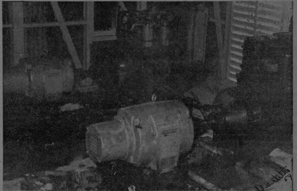
Fotografía tomada a la planta diésel funcionando en la finca Cartago, la que da luz a Finca Cartago y Finca Puntarenas; próximamente funcionará la otra unidad que dará fuerza eléctrica para la Finca Guanacaste.
