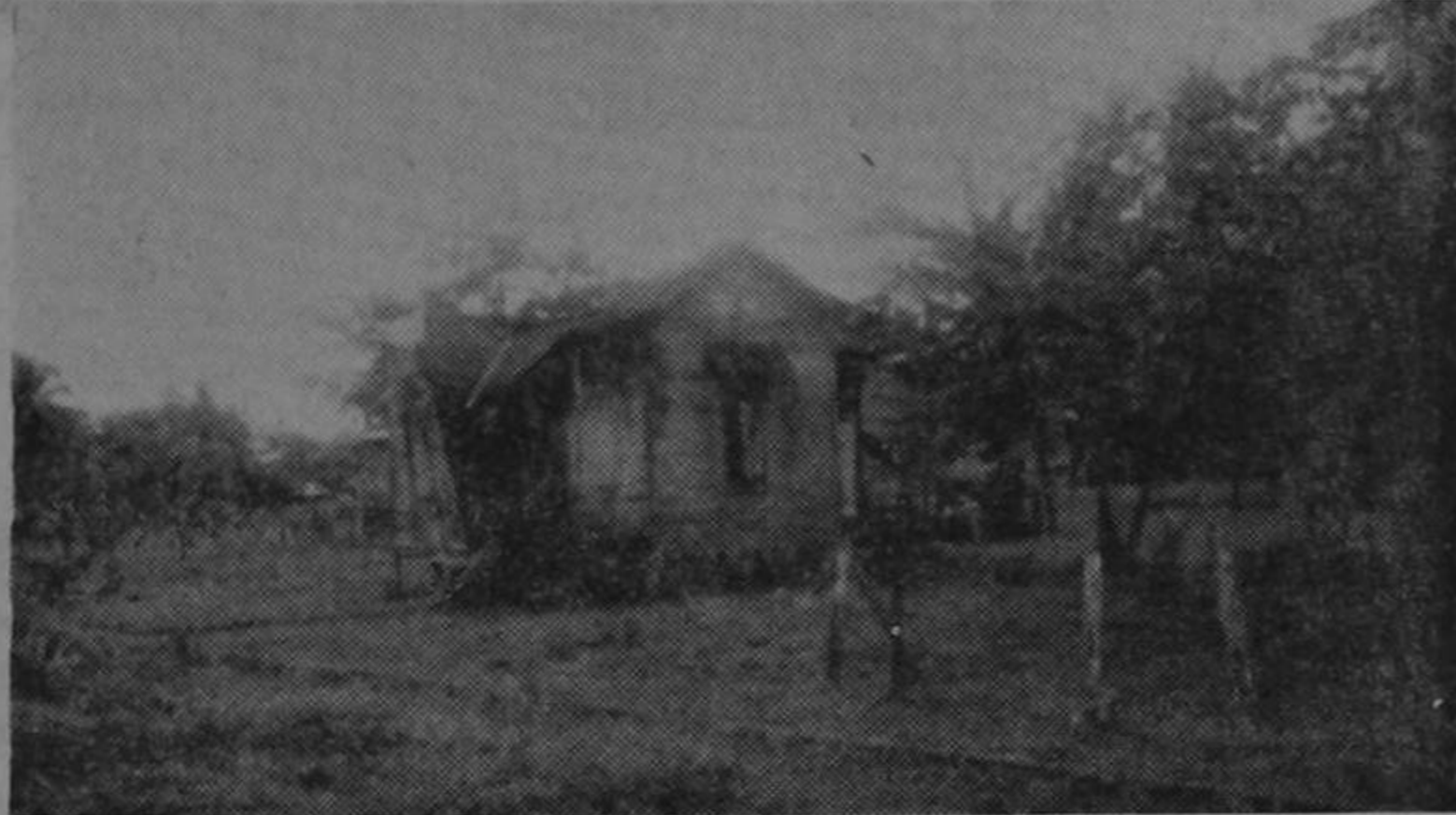
He aquí una vieja casa. Ya no sirve; el techo se hundió y las paredes no resisten ni un leve golpe. Es, quizá, la construcción más vieja de Matina, que data de los años noventa del siglo pasado. Nadie la habita, y permanece allí hasta que el tiempo se encargue de consumir su obra de destrucción.
