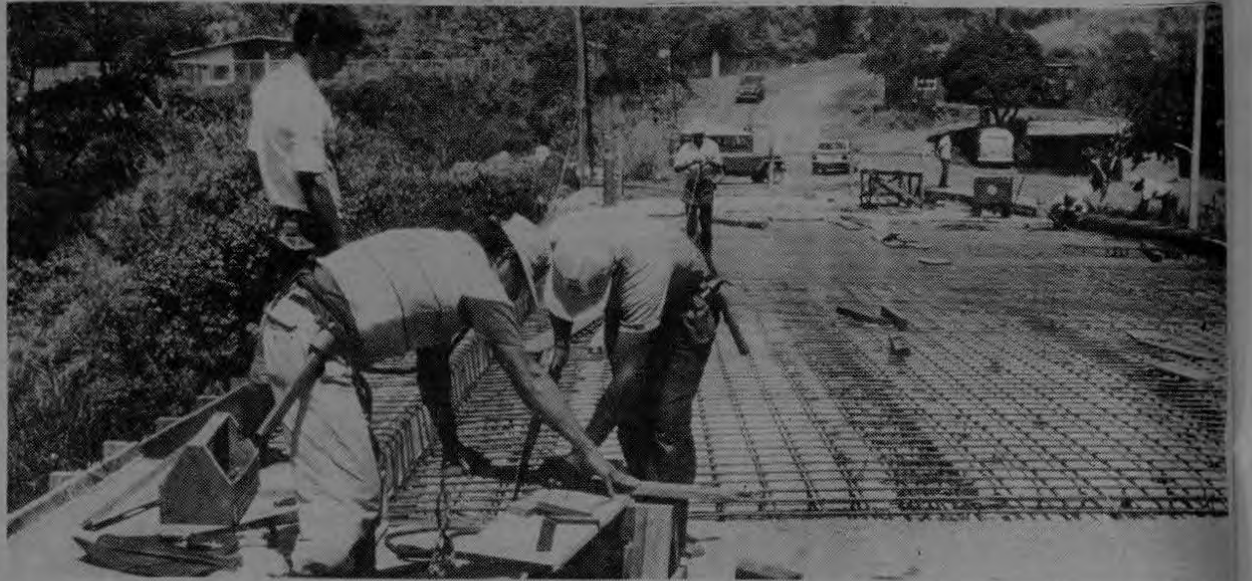
Ayer, trabajadores de CAMUSA terminaban la armadura. Mañana inician la chorrea de la losa y, posiblemente, en 15 días el paso quede totalmente rehabilitado para vehículos de carga y autobuses. (K. Villegas)
